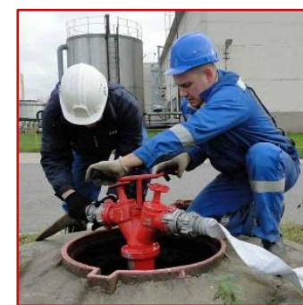
Аварийный запас воды
